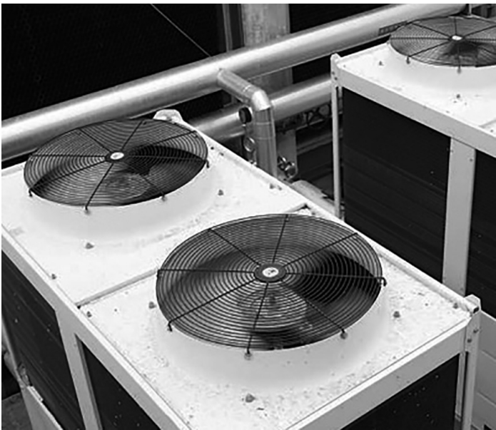
用以替代燃气锅炉的空气源热泵
